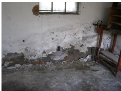
zadní stěna narušená vlhkostí
