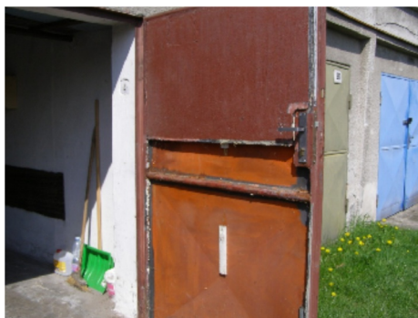
původní vrata - koroze
