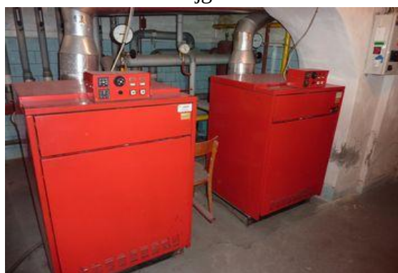
Dva kotle na zemní plyn
