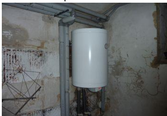
Elektrický bojler v 1.PP
